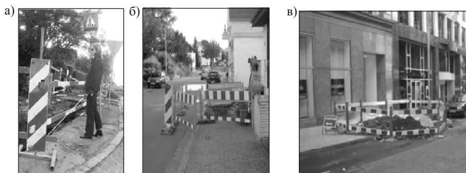
Рисунок 60 – Примеры (а, б, в) обустройства мест проведения дорожных работ ограждениями, обеспечивающими безопасность движения инвалидов
