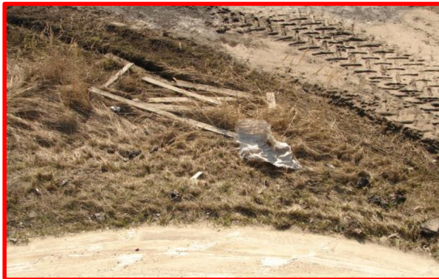
Не очищена подмостовая зона от посторонних предметов
