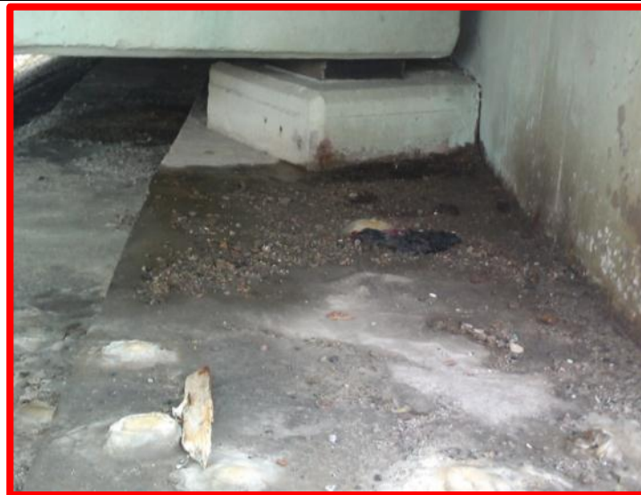
Не очищена верхняя площадка опор от мусора
