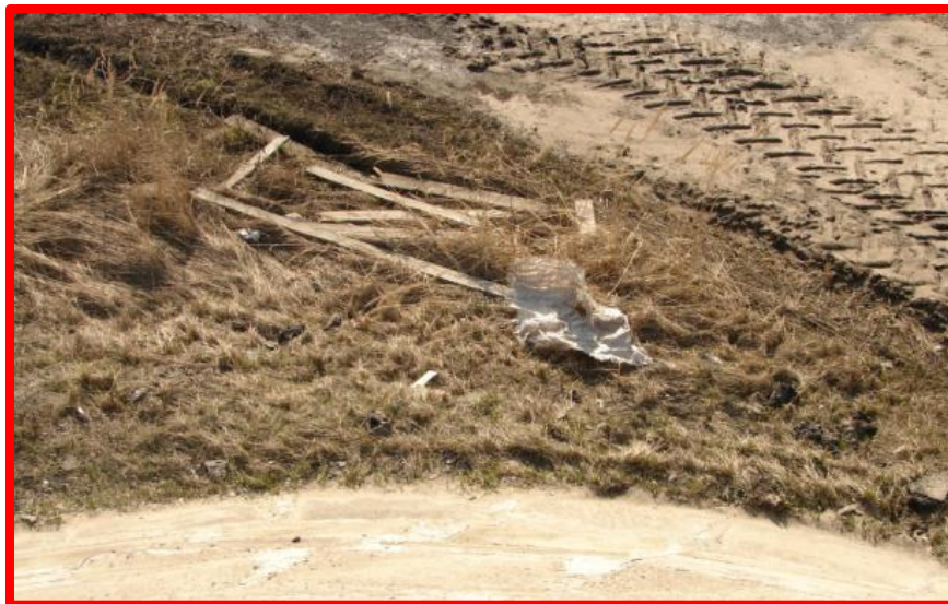
Не очищена подмостовая зона от посторонних предметов
