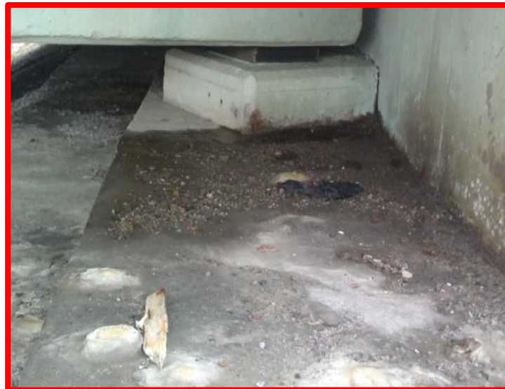
Не очищена верхняя площадка опор от мусора
