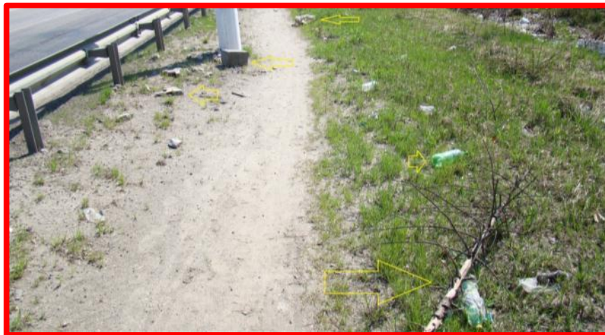
Наличие мелкого мусора на откосах
